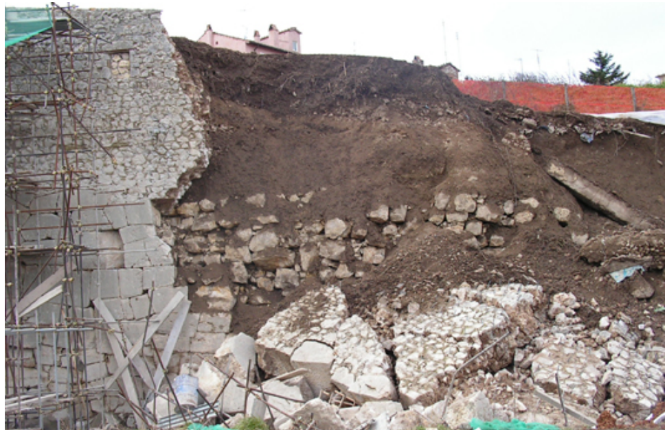
Figura 1.14 - Due viste del crollo avvenuto il 18 gennaio 2006
