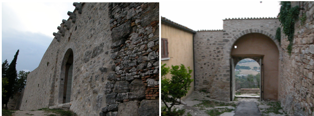
Figura 1.13 - Porta della Valle (da sinistra) vista da fuori ed entro le mura.
