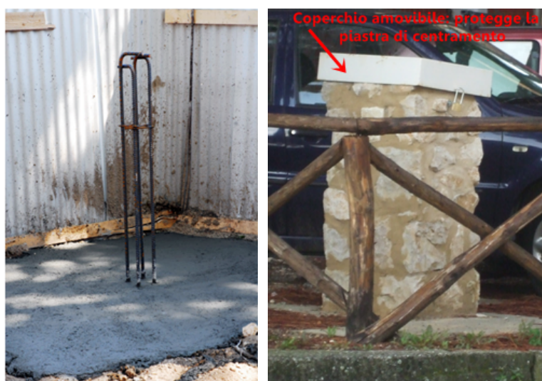
Figura 30 - Materializzazione del vertice E100 nella zona E, a sinistra in fase di esecuzione e a destra a lavori ultimati
